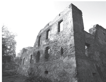
Die Ostmauer der Ruine war 2011 teilweise eingestürzt.
